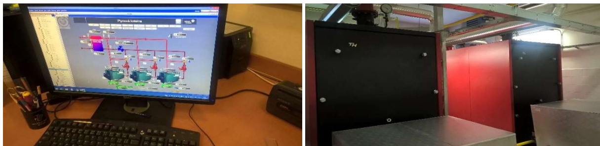
Obrázek 7: Kotelna a stanoviště obsluhy kotelny
