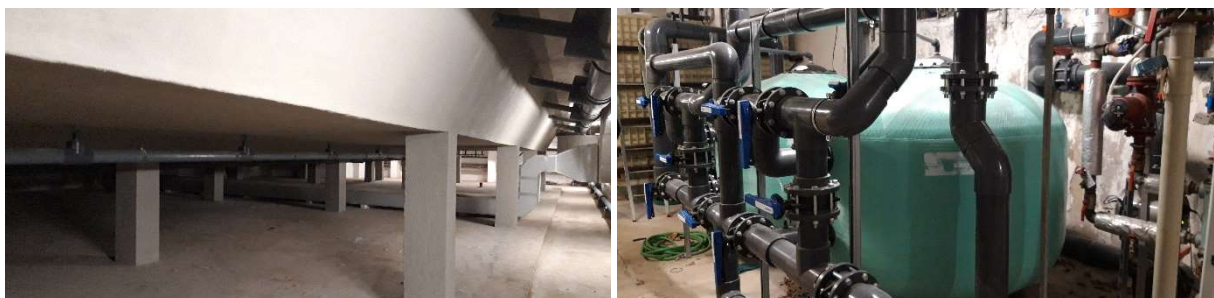
Obrázek 2: technologické prostory pod betonovou vanou bazénu a v úpravně vody
