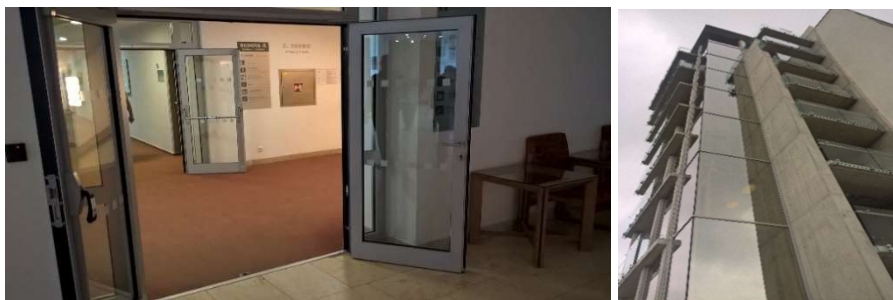
Obrázek 5: Požární dveře u vstupu do budovy A a požární evakuační výtah u stejné budovy
